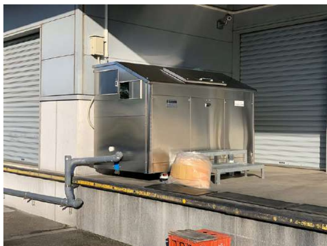
丸亀市飯山学校給食センターに設置した食品残渣発酵分解装置
